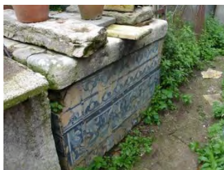
Boca de eventual cisterna no logradouro
